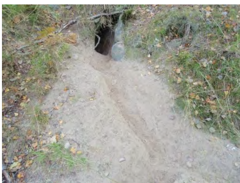
Bild 8. Grävlingsgryt i vägbanken användes 2012.
